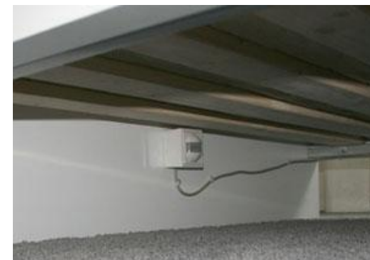
Nachtbeleuchtung per Bewegungsmelder
